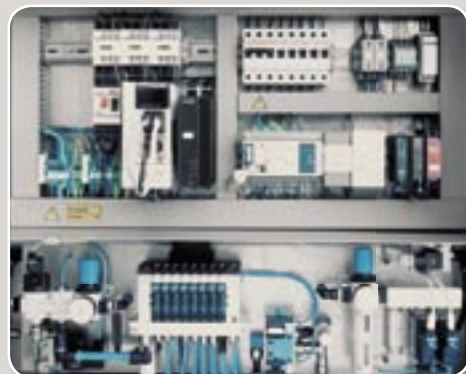
Servicefreundlich: Alle wichtigen Bauteile sind im Schaltschrank gut von vorne erreichbar.
